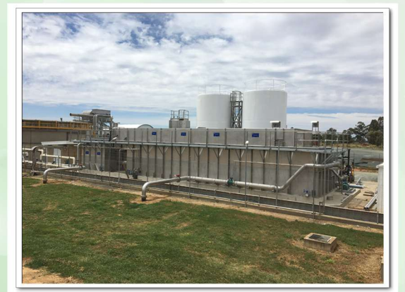
Fonterra Stanhope, Vic - WWTP
